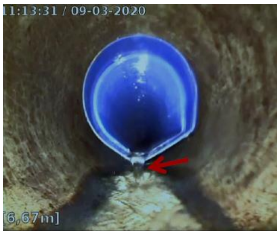
Télescopage drain à fond plat dans canalisation fonte. Drain n°4
