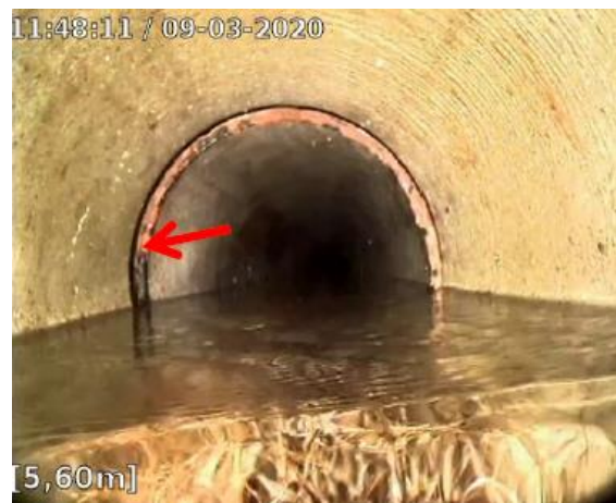
Jonction canalisation fonte décalée. Drain n°5.
