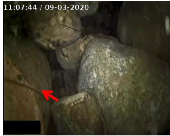
Illustration. Galets entre les drains n°1 et n°2 (la flèche rouge matérialise pointe vers la canalisation, béton du drain n°1.
