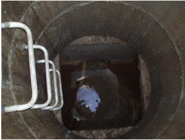
Captage Sud du Bois d'Anthy. Intérieur.
