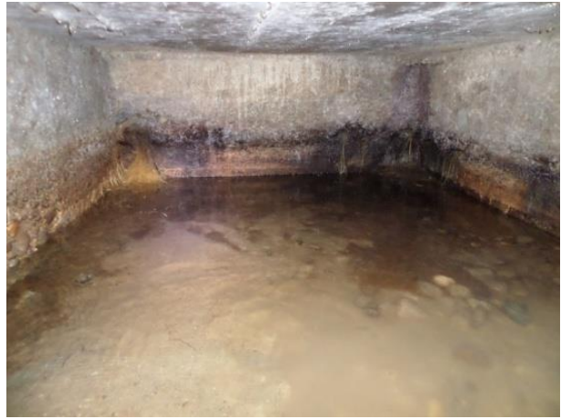
Captage Sud du Bois d'Anthy. Intérieur de la chambre de réunion.
