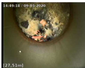
Vue du fond de l'ouvrage (présence de dépôts et potentiellement de floccs bactériens)
