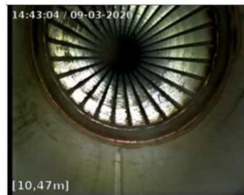
Vue du débit des crépines
