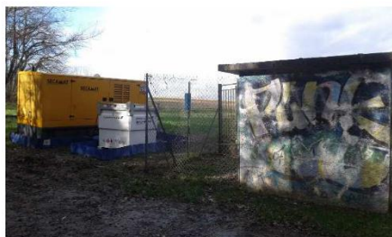
Groupe électrogène et chambre de mélange
