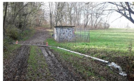
Chambre de mélange et point de rejet des eaux de pompage
