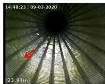
Vue des crépines (flèche rouge : concrétions sur crépines)
