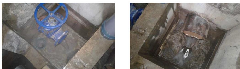
Figure 15 : Installations de la chambre de réunion du Bois d'Anthy (canalisations Ø400 et Ø200 mm)
