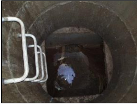
Captage accessible via une échelle à l'intérieur d'un tampon Foug
