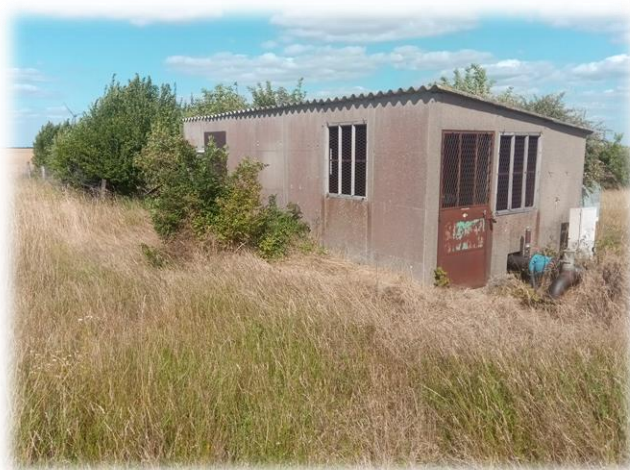
Figure 92 : Photographie d'une cabane de pompage présente au sein de la ZIP
