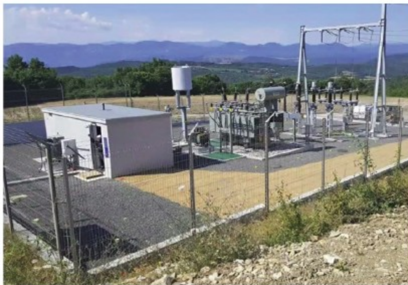
Figure 4 : poste de livraison et ses équipements associés (source : étude d'impact)
