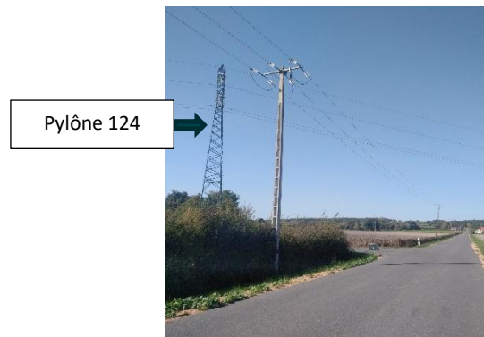
Figure 47 : pylône 124 de la liaison aérienne Dompierre-Varennes-sur-Allier
