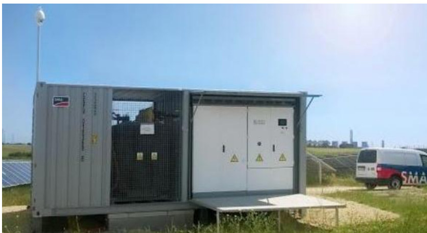
Figure 40 : Exemple poste de transformation (source : SOG Solar)
