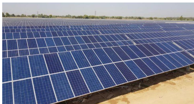
Figure 36 : Exemple de tables sur structures (source : Optimum Trackers).
