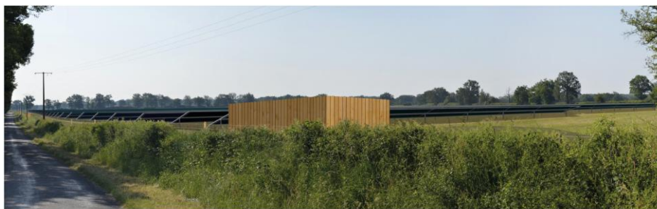
Malgré la présence de la haie bocagère basse (1 à 1,5m de haut environ), le projet se révèle sur l'ensemble du champ visuel. Les postes électriques de transformation en arrière de la haie bordent la RD 32. Il font l'objet d'un traitement de façade en bois qui gèrera avec le temps. On peut apercevoir quelques émergences du poste HTB en arrière plan.
