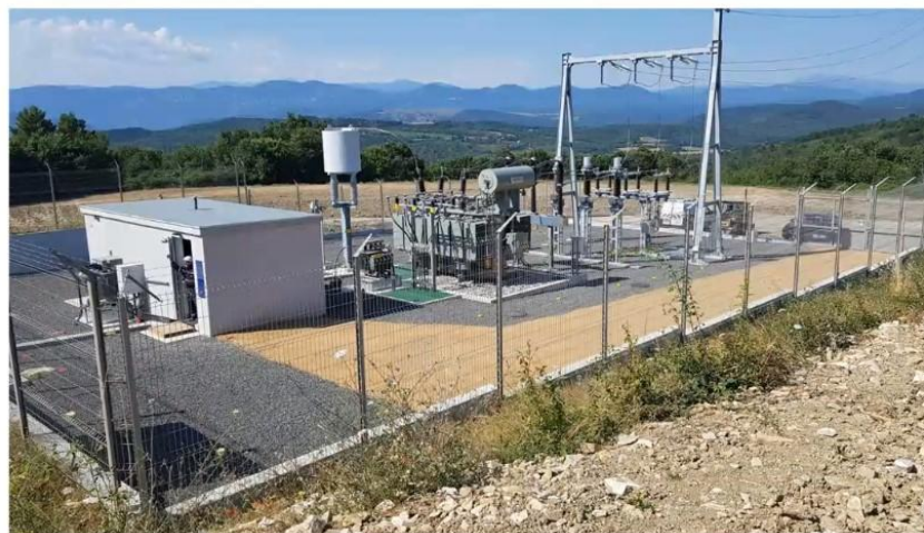
Figure 42 : Exemple de Poste de livraison HTB avec raccordement aérien (bâtiment, transformateur, portique et autres équipements HTB)
