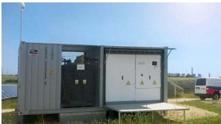
Figure 6 - exemple de Poste de transformation
