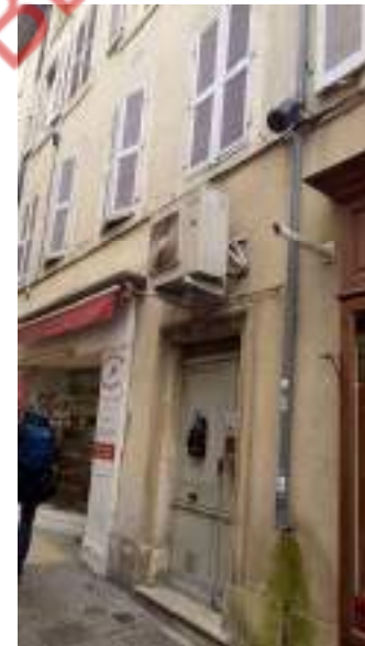
Unités extérieures de pompe à chaleur
