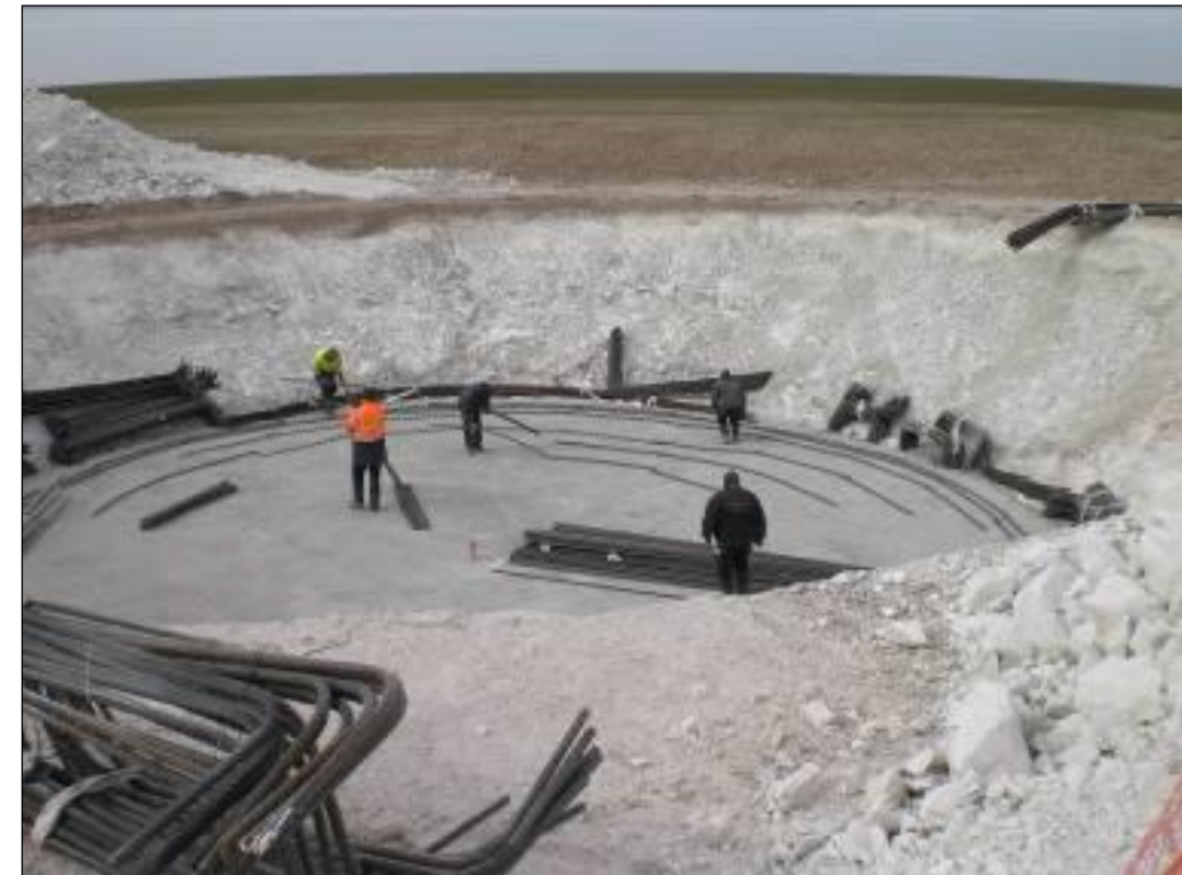
Photo 125 : Exemple de fondations à remettre en état
