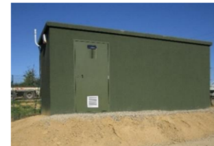
Figure 40. Exemple d'un poste de livraison (source : Enerparc)
