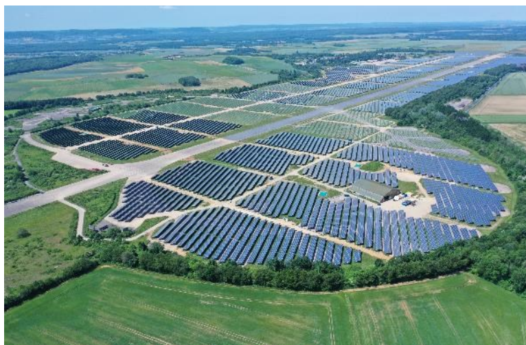
Figure 9: Photographie de la centrale photovoltaïque au sol d'ENERPARC à Marville
