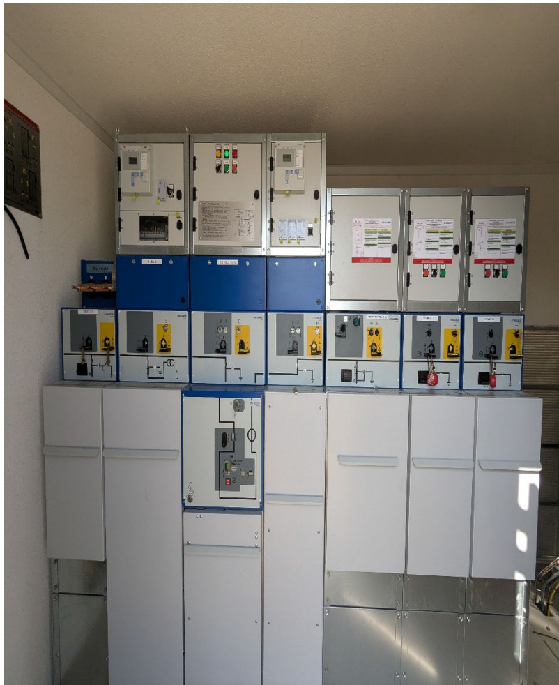
Figure 6: Armoire électrique dans le PDL
