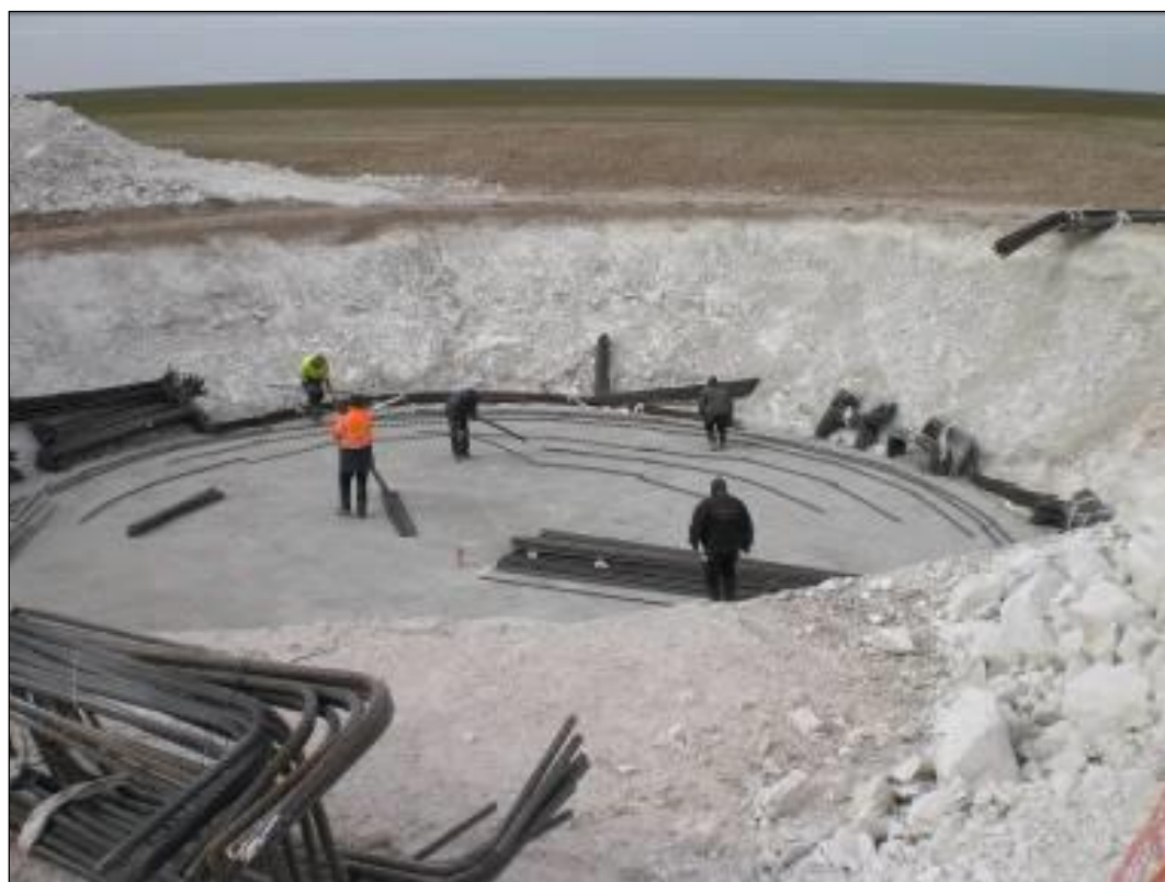
Photo 135 : Exemple de fondations à remettre en état (Source : BE JC)
