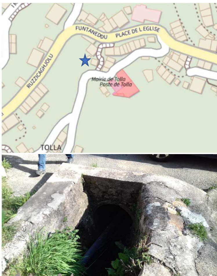
Figure 9 : Localisation et photographie de la conduite régulièrement obstruée par des embâcles
