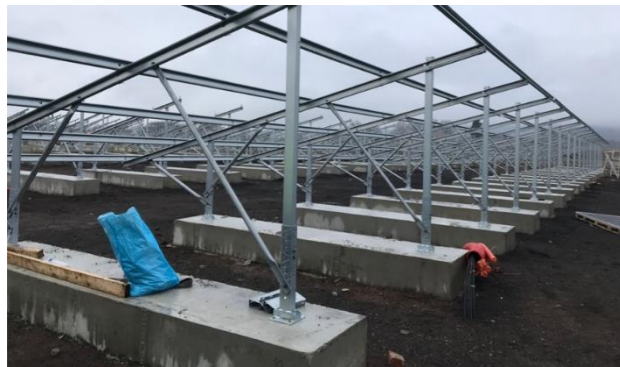
Exemple de fondations superficielles de type longrines en béton ou gabions (Sources : EDF Renouvelables)
