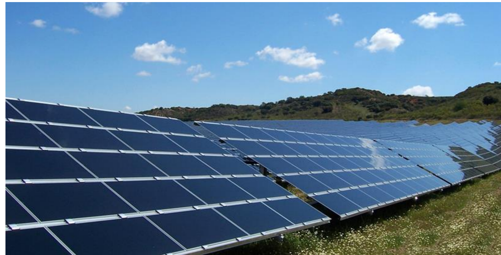
Parc photovoltaïque EDF Renouvelables de Narbonne
