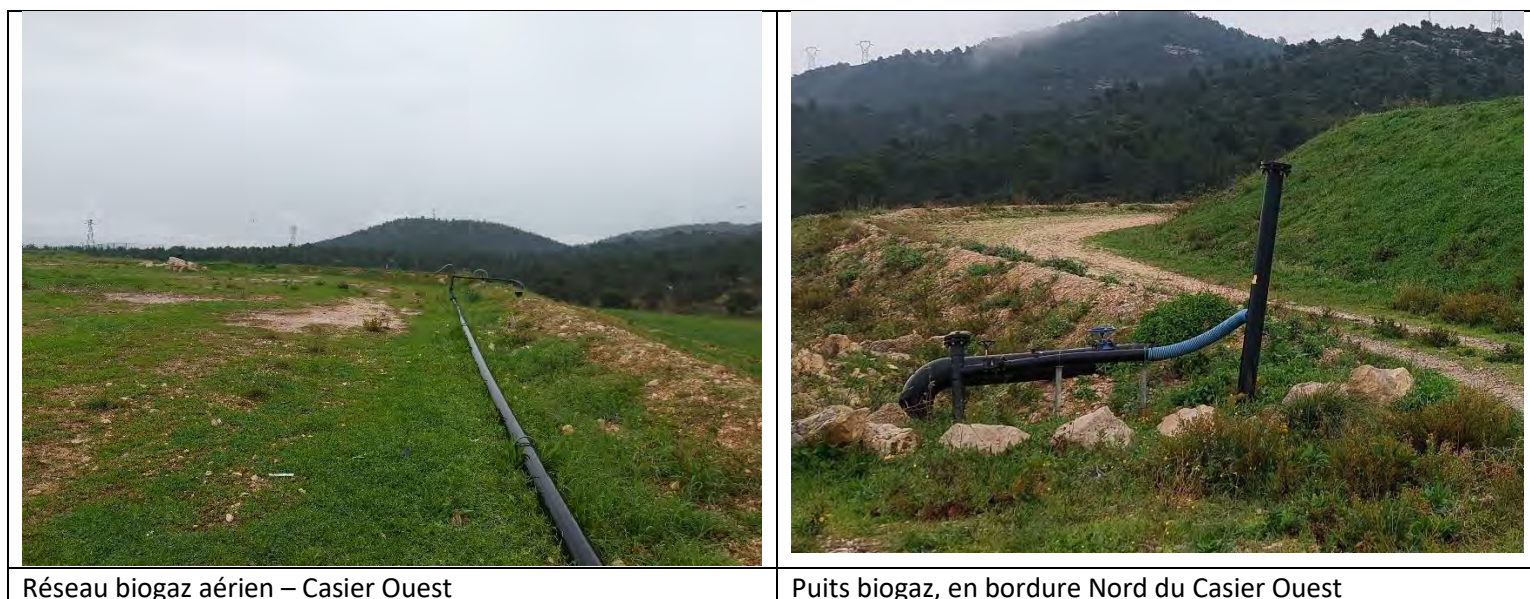
Figure 7 : Photographies des réseaux biogaz – casier Ouest
