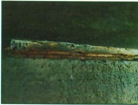
Figure 42 : AA-P2-RD - Corrosion des frettes, élastomère craquelé
