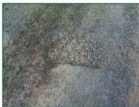
Figure 32 : Dégradation du revêtement
