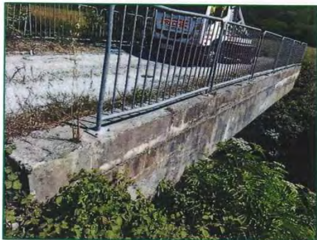
Figure 39 : Couloirs de calcite entre longrine / dalle / poutre
