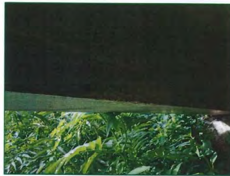
Figure 38 : Nid de cailloux sur poutre P1
