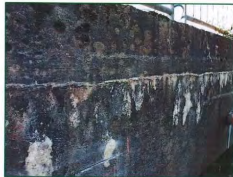
Figure 40 : Couloirs de calcite entre longrine / dalle / poutre
