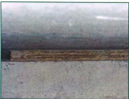
Figure 46 : AA-P3-RG - Corrosion des frettes, élastomère craquelé
