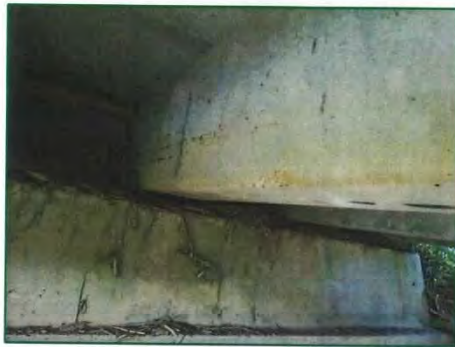
Figure 37 : Epaufrure sur poutre P4
