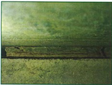
Figure 44 : AA-P6-RD - Corrosion des frettes, élastomère craquelé
