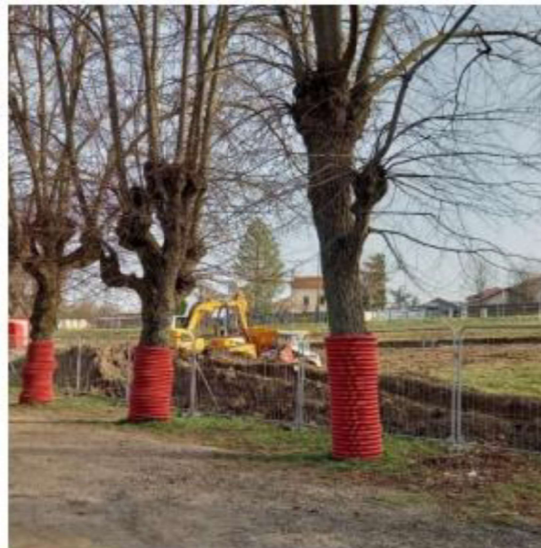
Figure 14 : Exemple de protection
