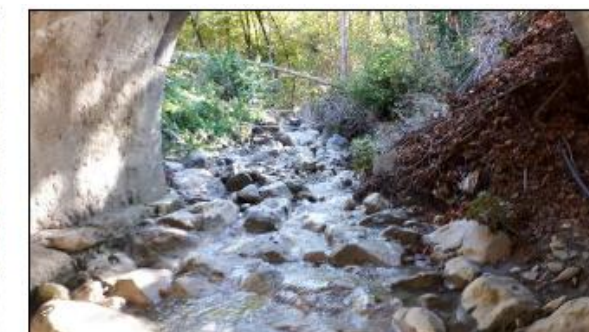
Radier du pont de la RD4202 et dépôt de déchets verts en amont immédiat
