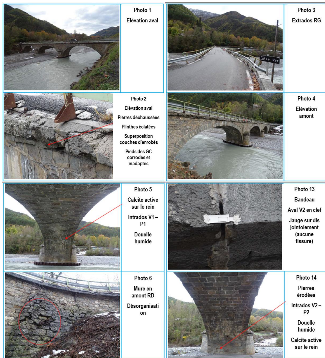
Figure 8 : Photographies illustrant les désordres du pont
