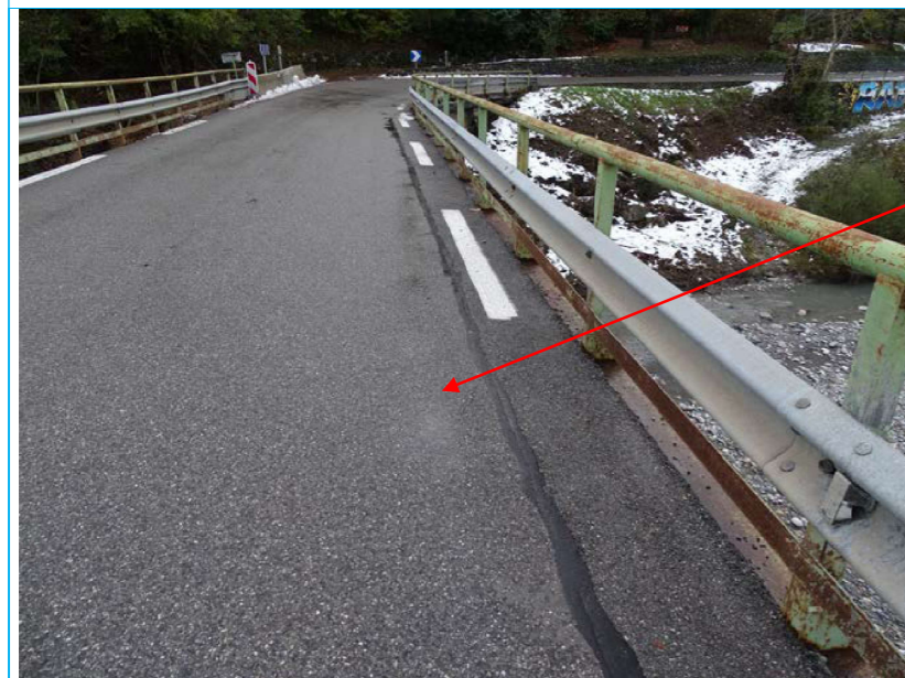
Photo 20 Chaussée Superposition des couches Flaches GC oxydé & non conforme
