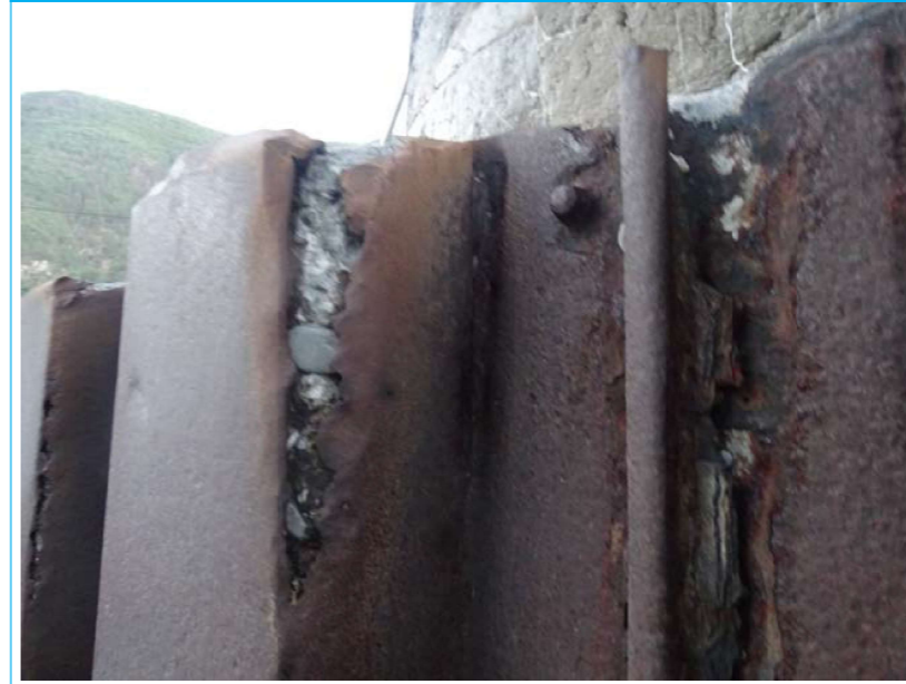
Photo 105 Inspection subaquatique Pile P1 face C0 Palplanches déchirées
