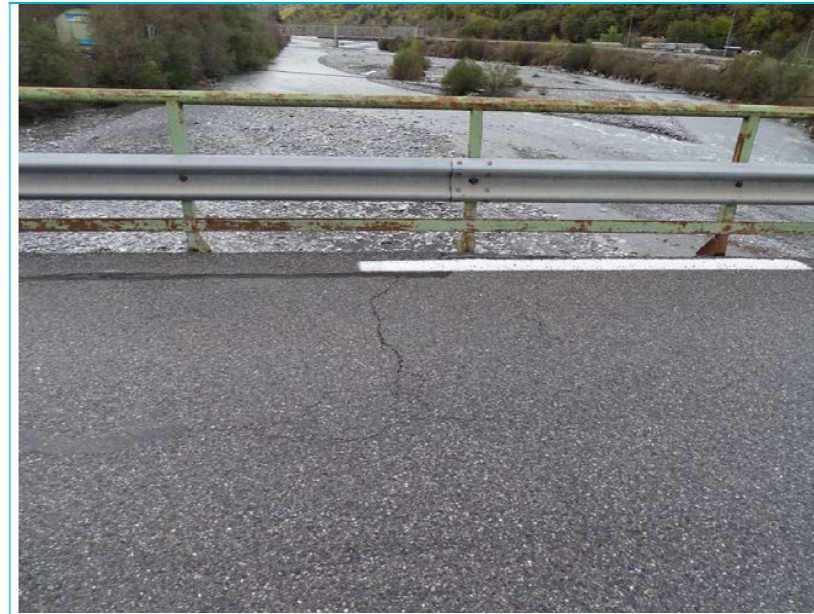
Photo 21 Chaussée Fissure transversale
