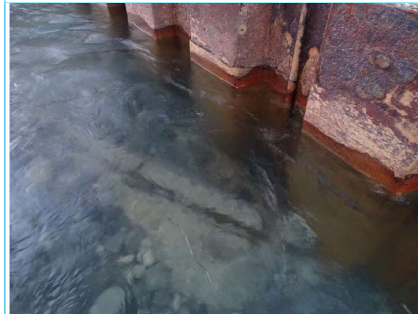
Photo 110 Inspection subaquatique Culée C3 Dépôt d'un bloc
