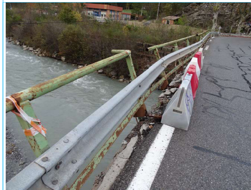
Photo 22 GC & GS amont Déformation, déversement Rupture de la lisse
