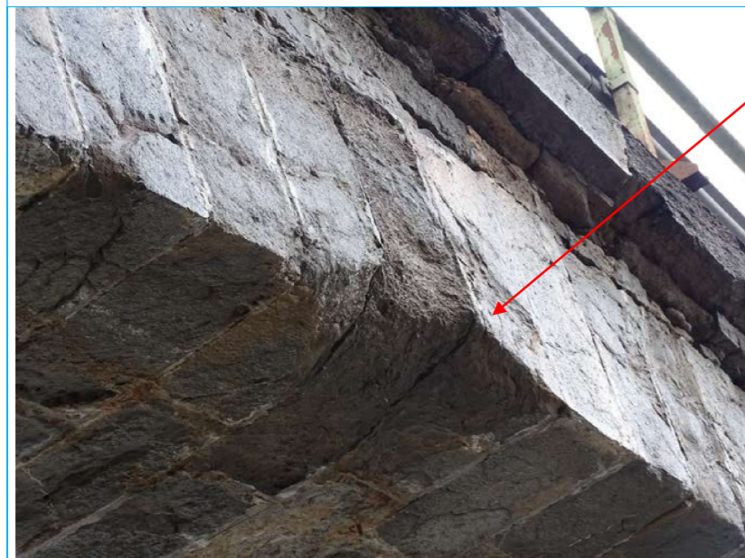
Photo 8 Intrados V3 Pierres de bandeau érodées
