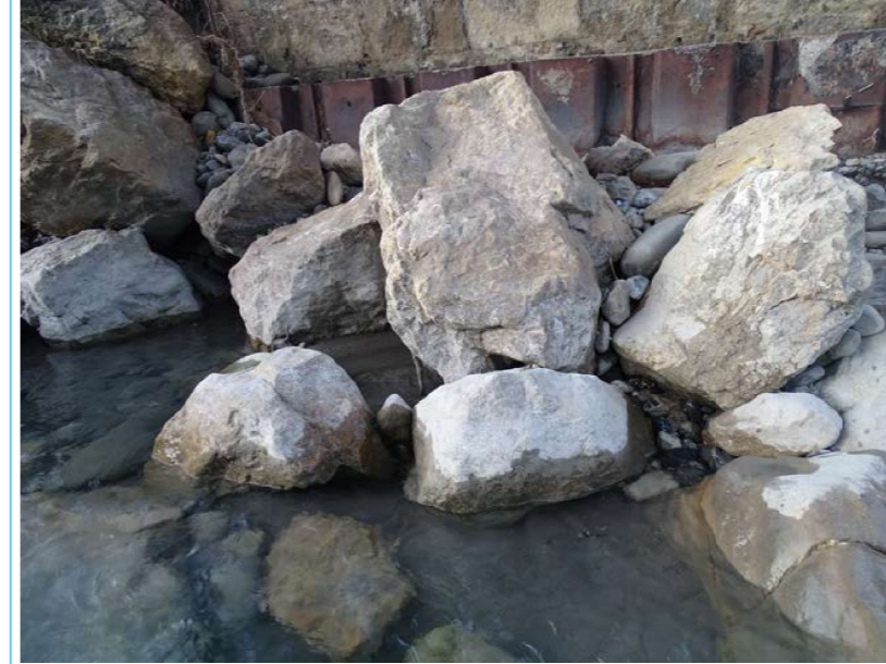
Photo 101 Inspection subaquatique Culée C0 Protection Désorganisation des enrochements
