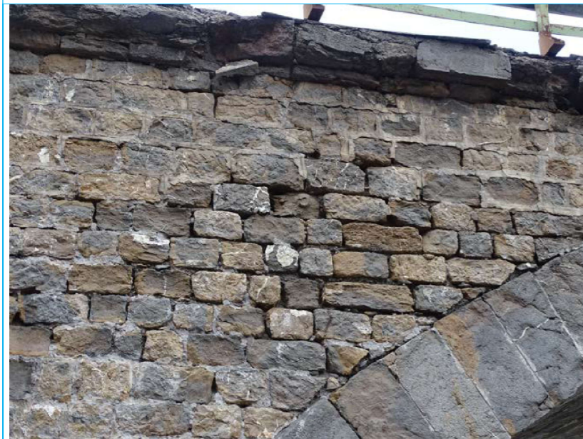
Photo 12 Elévation aval sur V2 Disjointoiement sur tympan Pierres éclatées
