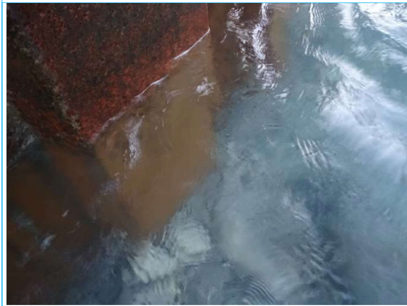
Photo 104 Inspection subaquatique Pile P1 face C0 côté aval Soubassement palplanches Lit de la rivière en galets Absence d'affouillement
