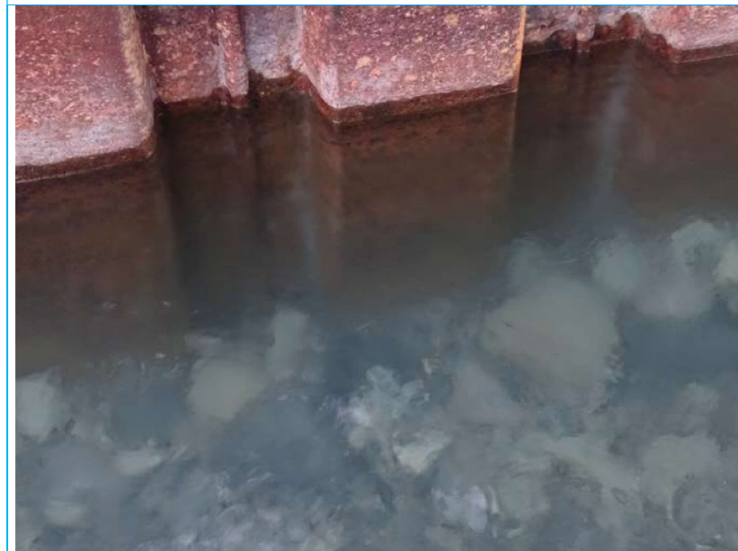
Photo 108 Inspection subaquatique Culée C3 côté aval Soubassement palplanches Lit de la rivière en galets Absence d'affouillement
