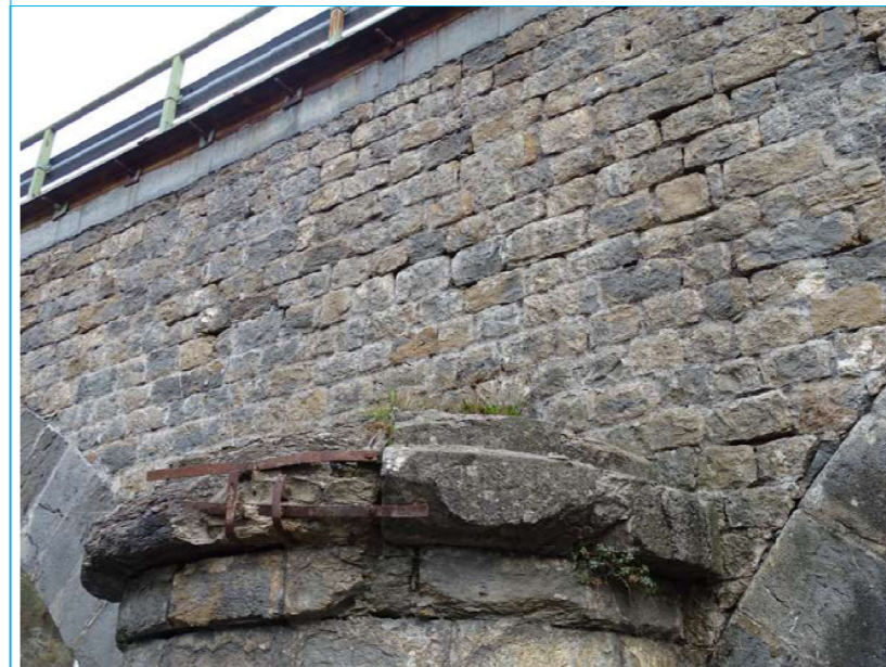
Photo 10 Pile P2 Avant bec Chaperon éclaté Disjointoiement sur tympan
