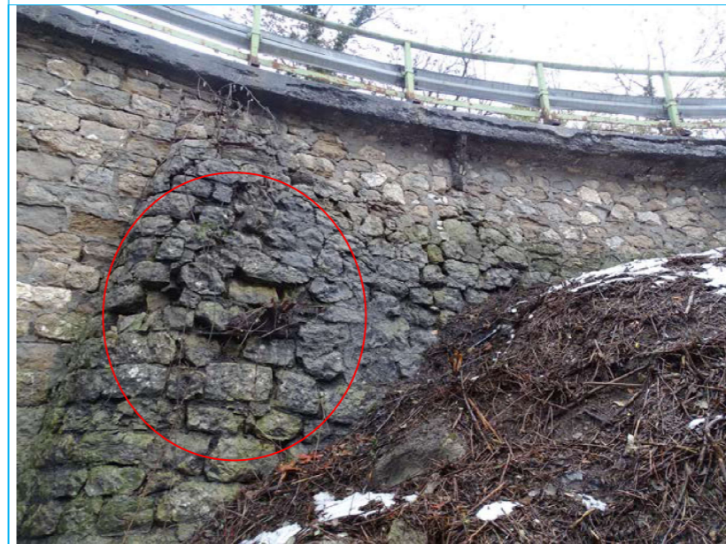
Photo 6 Mur en amont RD Désorganisation
