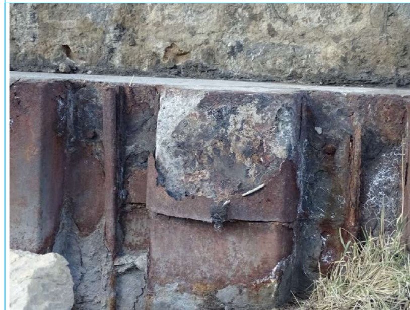
Photo 102 Inspection subaquatique Culée C0 Soubassement palplanche Partie supérieure déchirée et corrodée
