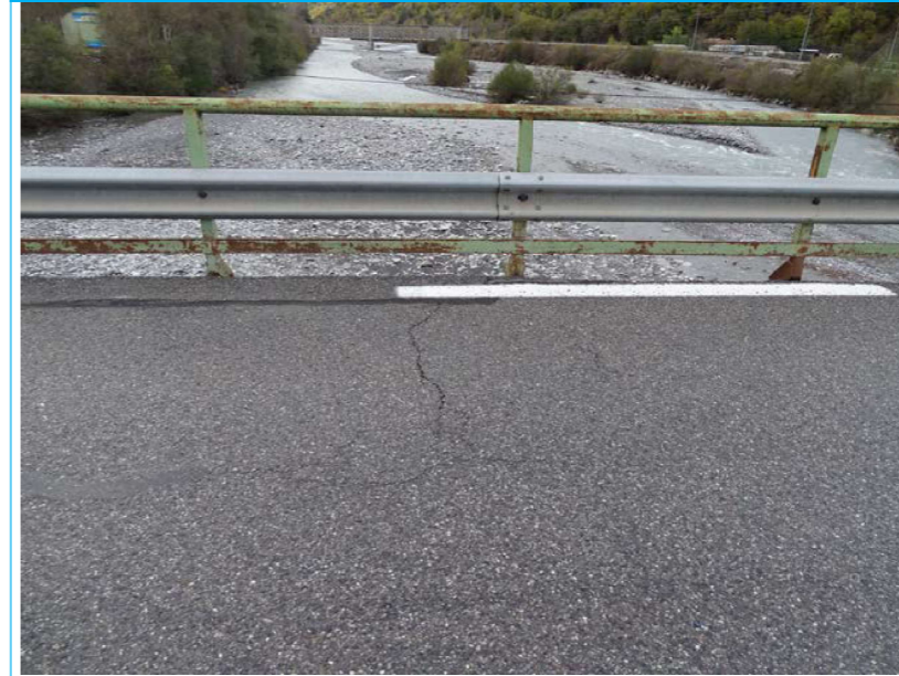
Photo 21 Chaussée Fissure transversale
