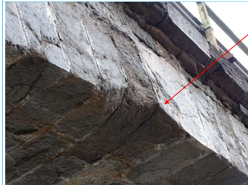
Photo 8 Intrados V3 Pierres de bandeau érodées
