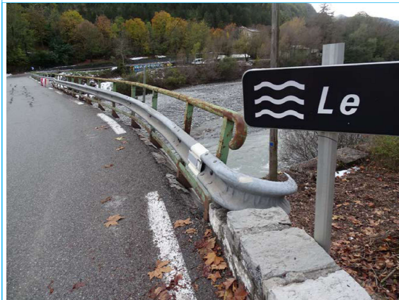
Photo 24 GC & GS amont en RG Déformation, déversement
