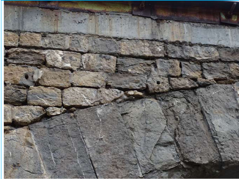
Photo 11 Elévation amont sur V3 Disjointoiement sur tympan Bandeau éclaté
