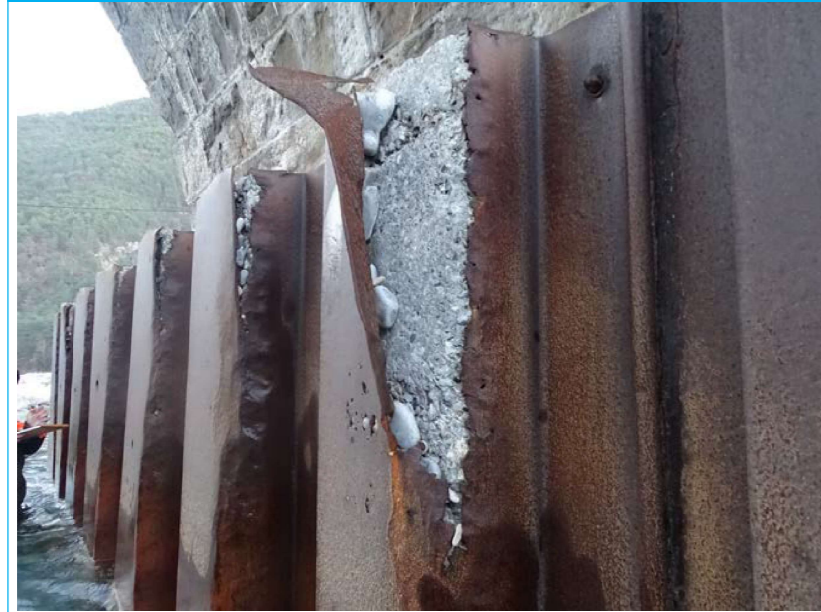
Photo 107 Inspection subaquatique Pile P1 face C0 Palplanches déchirées
