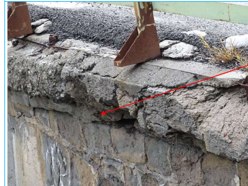
Photo 2 Elévation aval Plinthes éclatées Superposition couches d'enrobés Pierres déchaussées Pieds des GC corrodés et inadaptés
