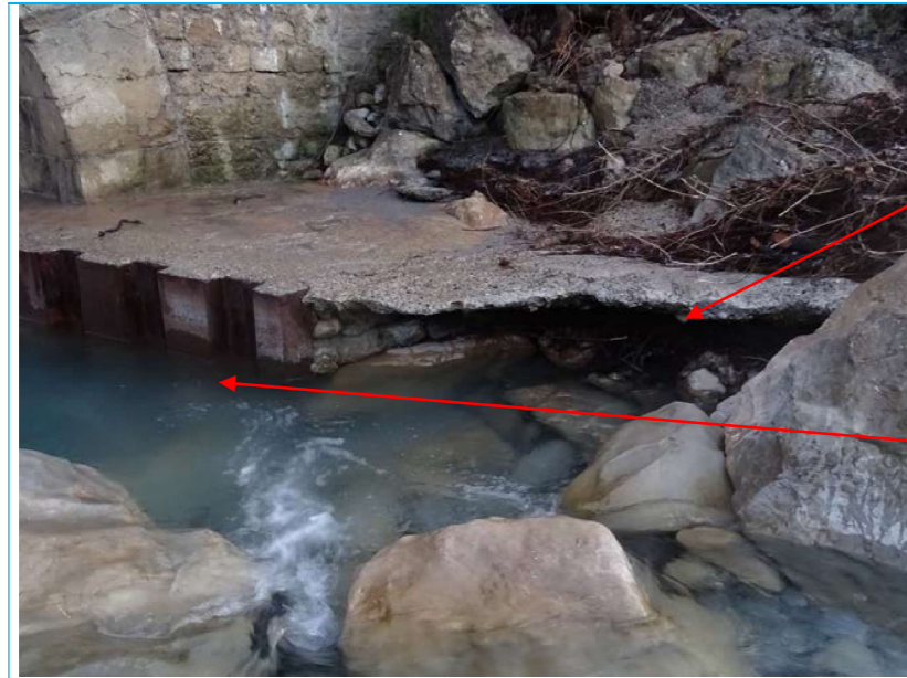
Photo 111 Inspection subaquatique Culée C3 Protection Affouillement 3,5 x 0.7 x 1 m Affouillement sous les palplanches (40 x 70 x 20 cm)
