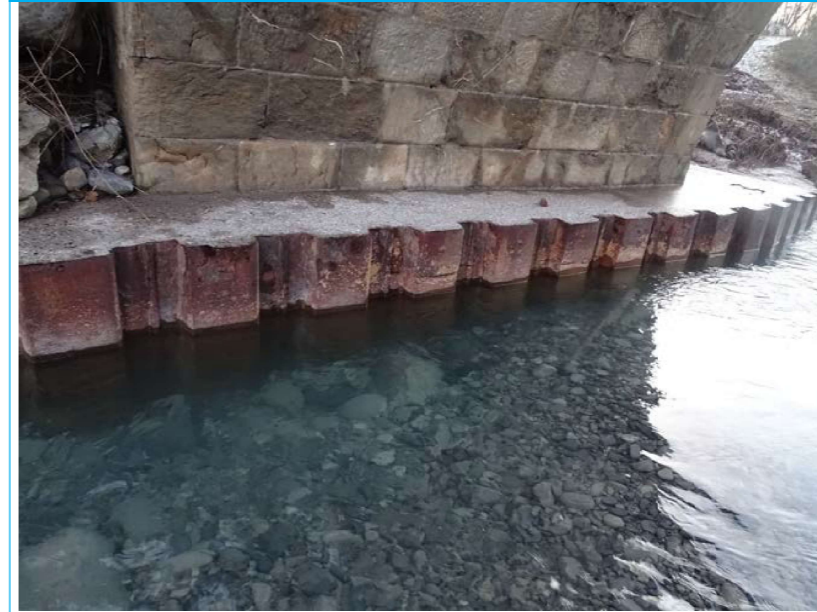
Photo 109 Inspection subaquatique Culée C3 côté aval Soubassement palplanches Lit de la rivière en galets
