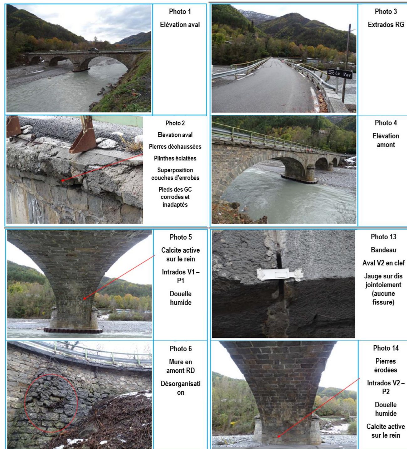
Figure 7 : Photographies illustrant les désordres du pont
