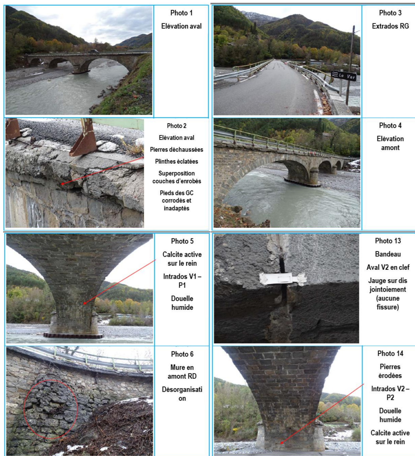
Figure 10 : Photographies illustrant les désordres du pont
