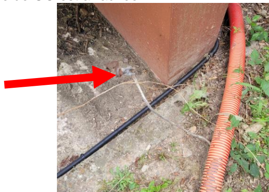
Photo 4 : Liaison équipotentielle cuve
