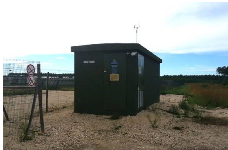
Figure 32 - Poste de livraison (exemple de finition vert). Source : Reden
