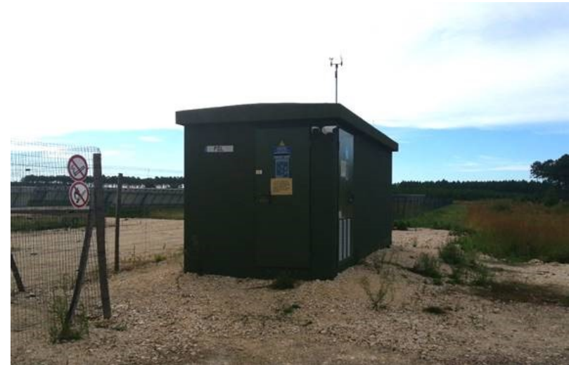
Figure 41 - Poste de livraison (exemple de finition vert). Source : Reden
