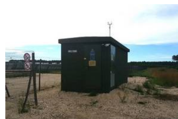
Poste de livraison (exemple avec finition vert et non sable clair).
