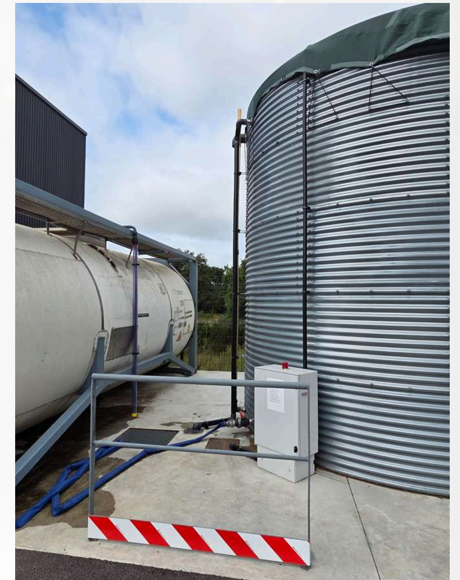
CUVE DE RECUPERATION DES EAUX DE TOITURE Economie : 400/450 m 3 par an
