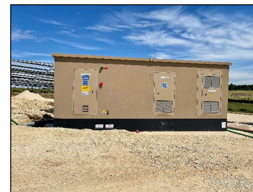
Exemple de poste de livraison
