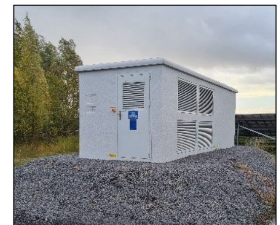
Exemple de poste de transformation
