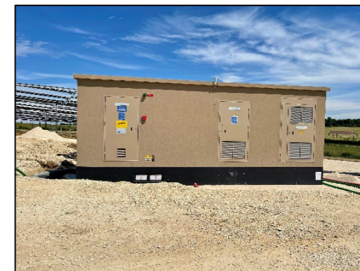
Exemple de poste de livraison
