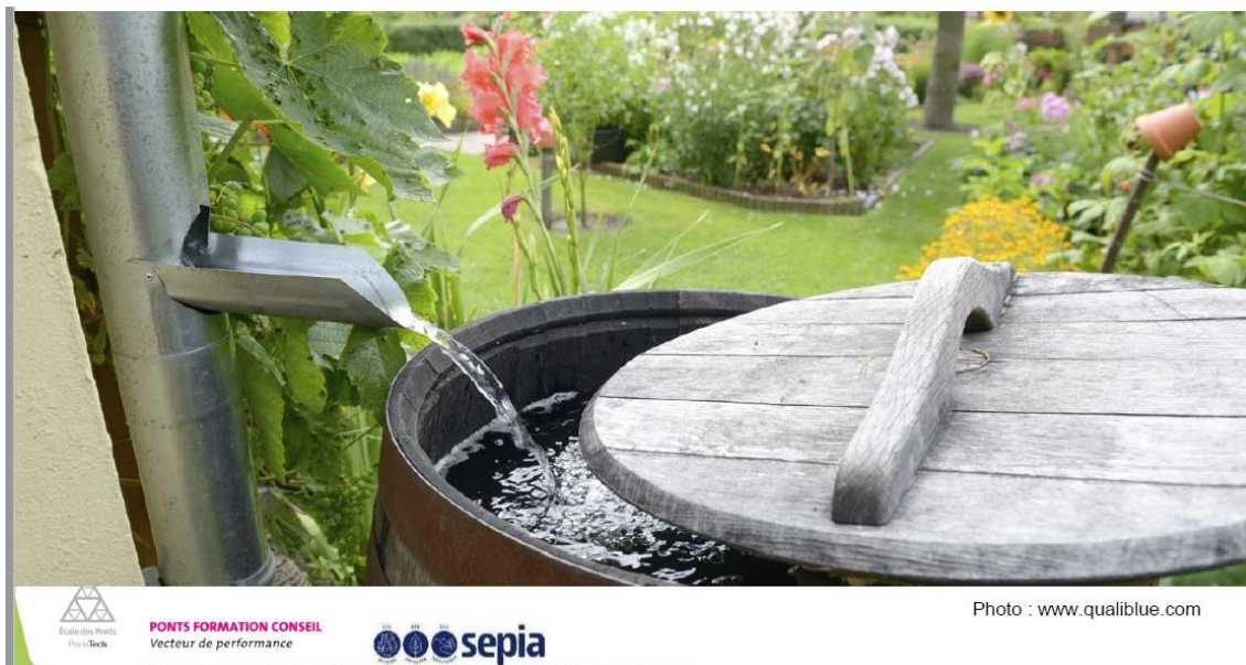
Figure 27 : Photo d'un exemple de stockage pour réutilisation en arrosage de jardin
