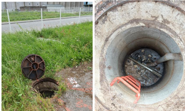
Figure 12. Regard Eaux usées domestique le plus à l'aval en partie privée
