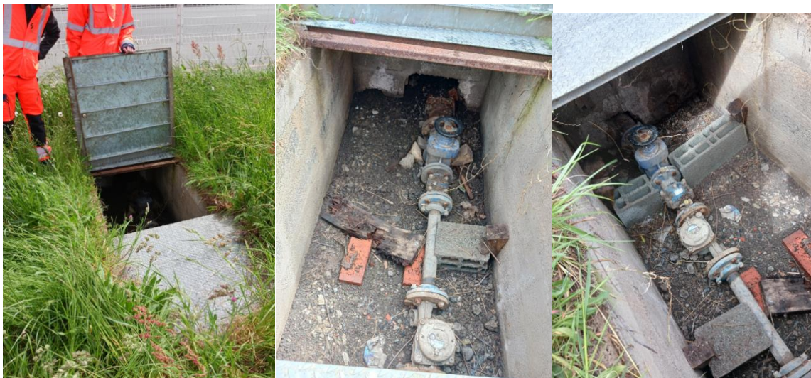
Figure 13. Chambre de comptage AEP
