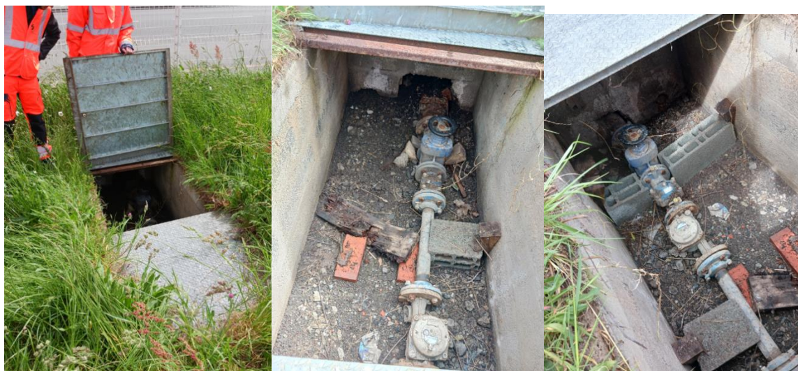
Figure 13. Chambre de comptage AEP
