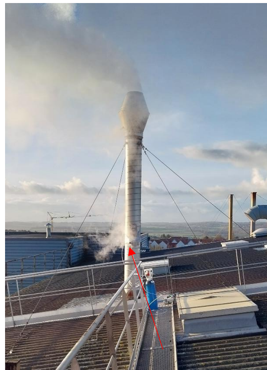
Photo 2 : Cheminée L2-2 (entrée four)
