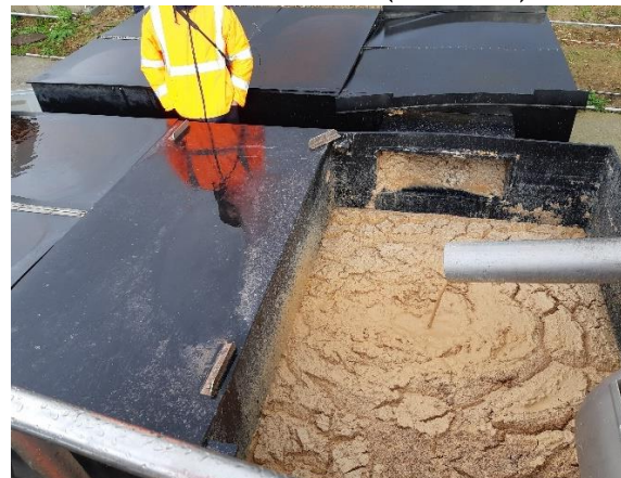
Photo 4 : Bac à boues
