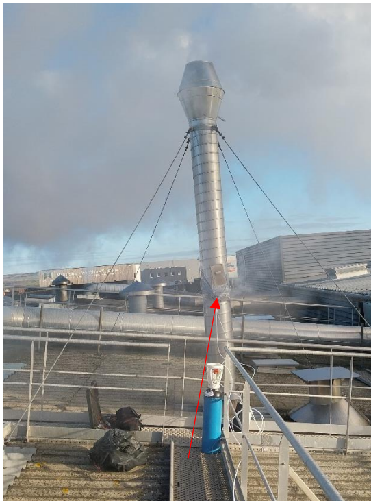
Photo 1 : Cheminée L2-1 (sortie four)
