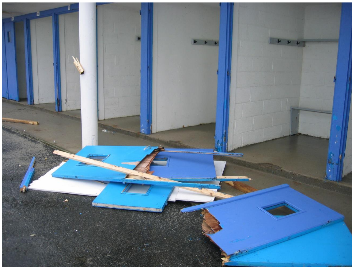
Fig. 27. Exemple de dégâts provoqués par des projections lors de la tempête du 10 mars 2011 à Perros-Guirec
