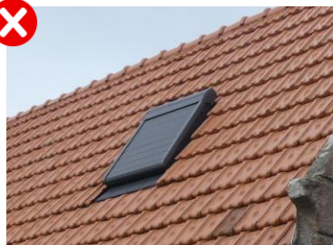
Châssis* de toit pas encastré dans la couverture.
