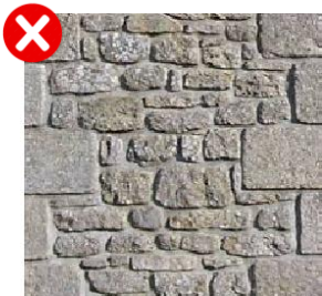
Joints trop creux, réalisés au ciment. © PACT - LTC
