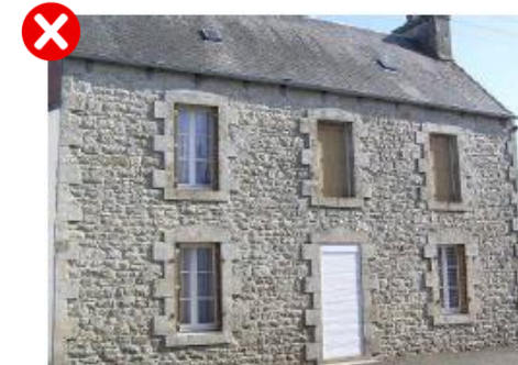
Pierre dénudée qui devrait être enduite au nu des encadrements.
