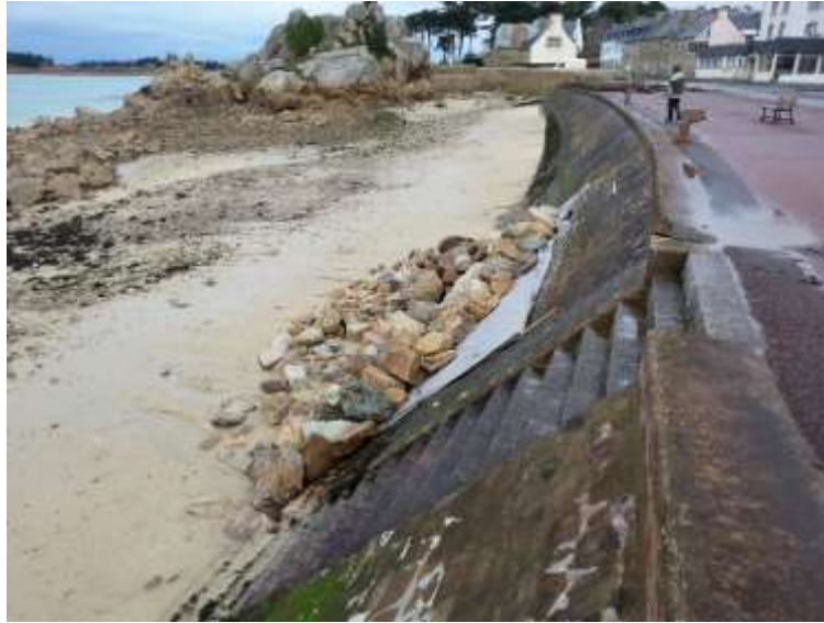
Figure N°11 : Protection du mur après tempête (10/2015)
