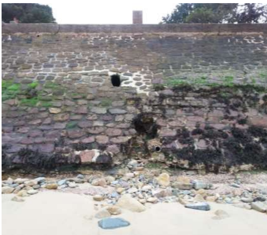
Figure N 5 : Sortie vers la mer de l'eau de pluie du parking de la Chapelle (03/2014)
