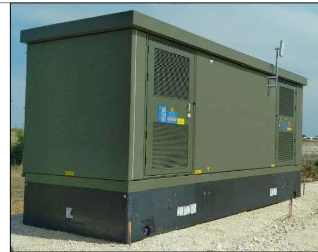
exemple de poste
