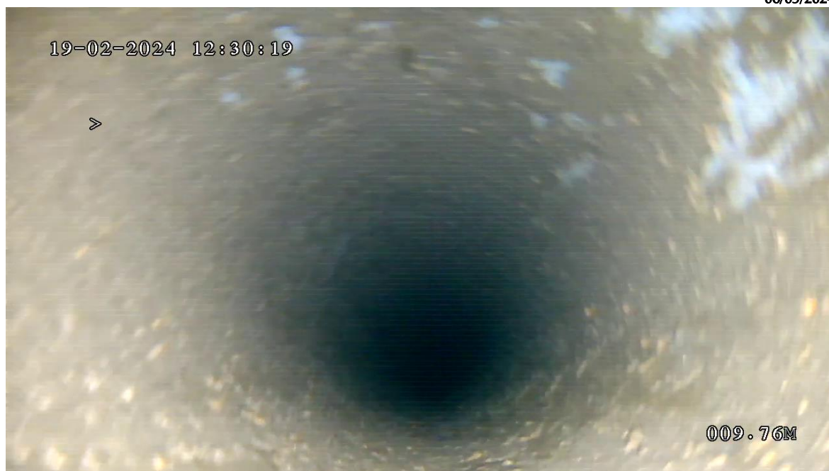
Abondants dépôts tapissant le tube plein
