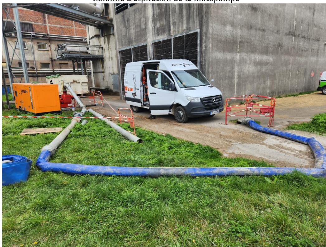
Ensemble du dispositif avec rejet dans le réseau EP du site
