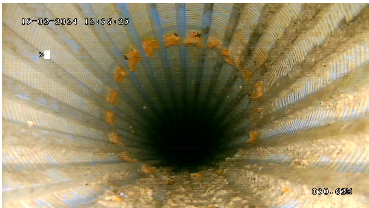
Abondants dépôts et encroûtements sur une face des crépines et encroûtement d'oxydes de fer localisé
