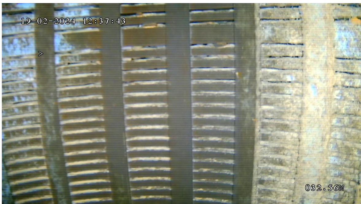
Dépôts noirs lisses d'oxyde de manganèse tapissant une partie des crépines
