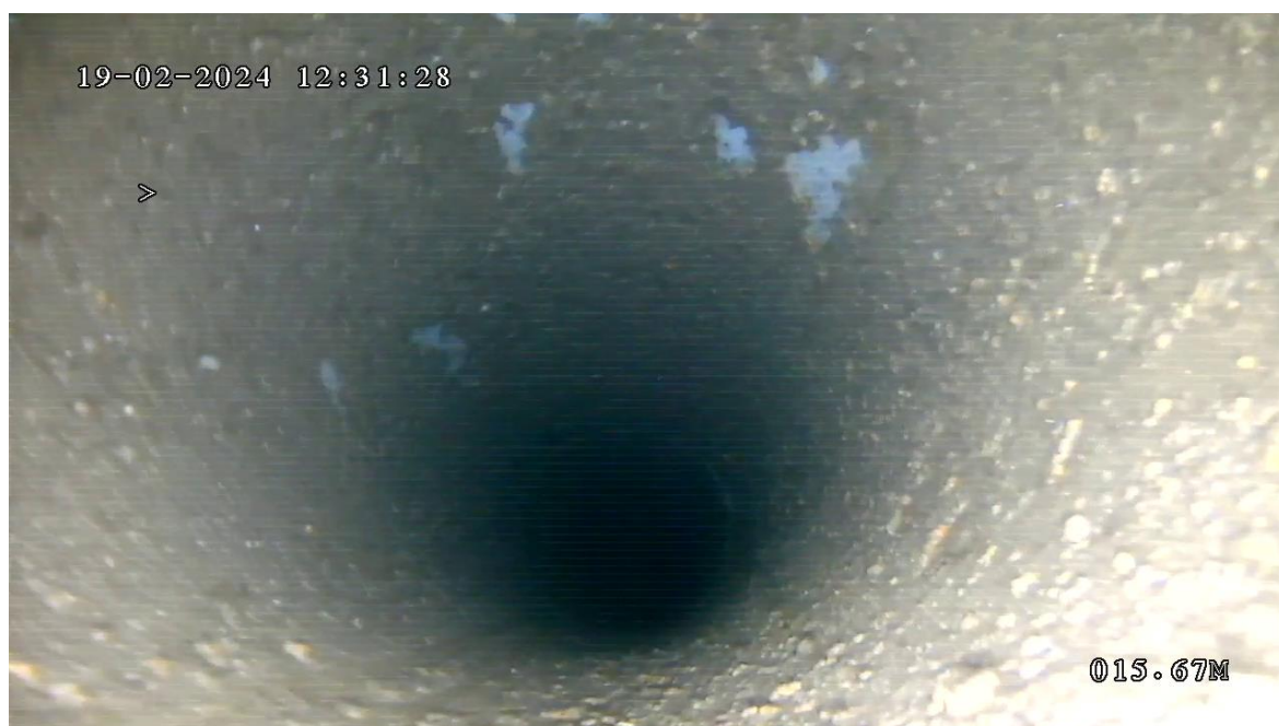
Abondants dépôts plus épais et d'aspect grumeleux
