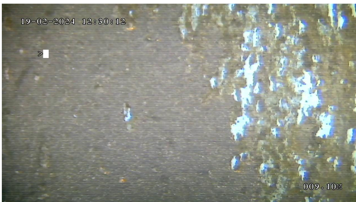
Abondants dépôts tapissant le tube plein
