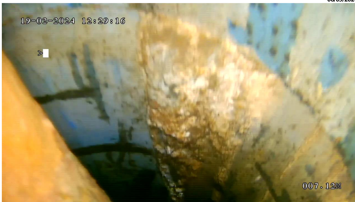
Encroûtements de carbonates sur un raccord
