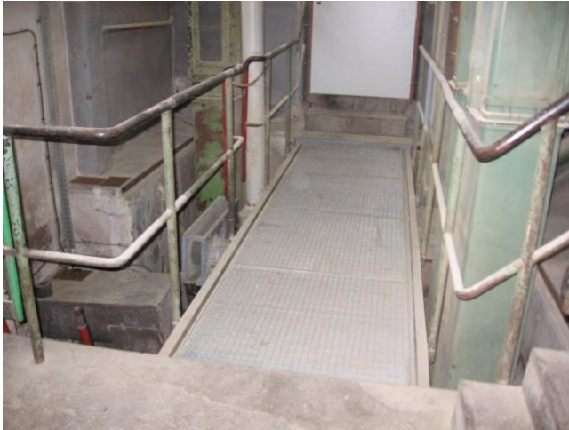
photo 11 (à gauche) : fosse d'élévateurs et RDC tour sont en communication directe : pas de plancher occultant, passerelle en caillebotis.
