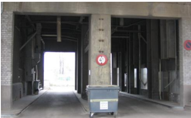
Photo 16 (à gauche) : vue du passage entre blocs Ouest et Est. Le grain est repris depuis le bloc Est via des élévateurs dont on distingue la partie basse (flèche).
