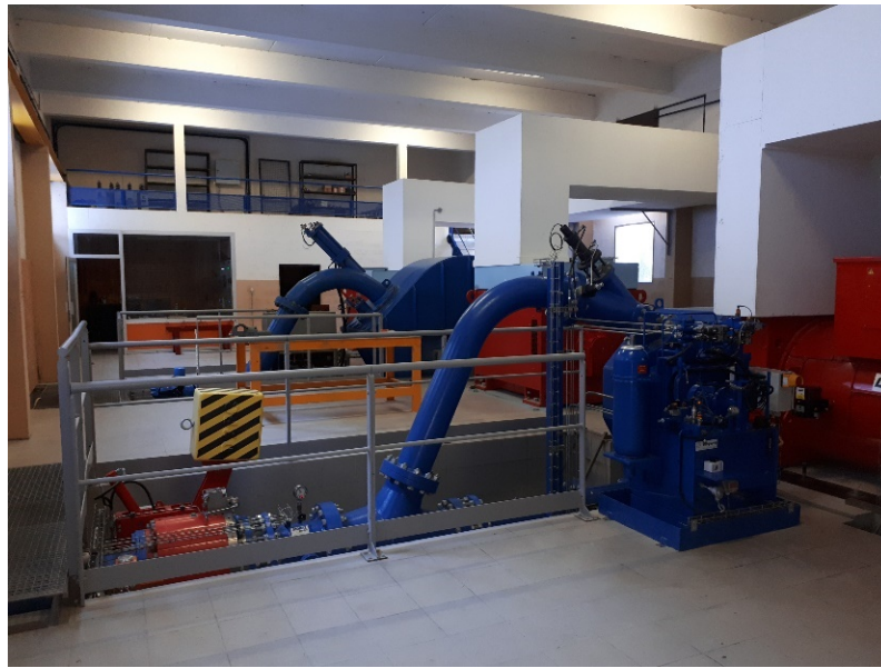
Image 8 : Photo des deux turbines
