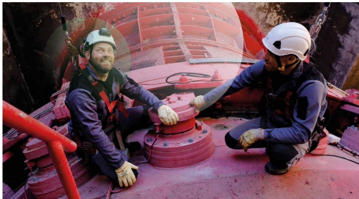
InnovAction CNR : poutre d'assujettissement et filin de sécurité pour opération de maintenance
