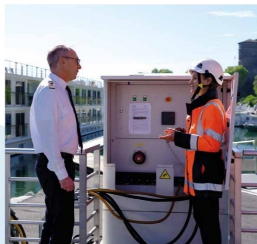
Borne haute tension pour l'alimentation électrique des bateaux à passagers de Tournon-sur-Rhône (07)
