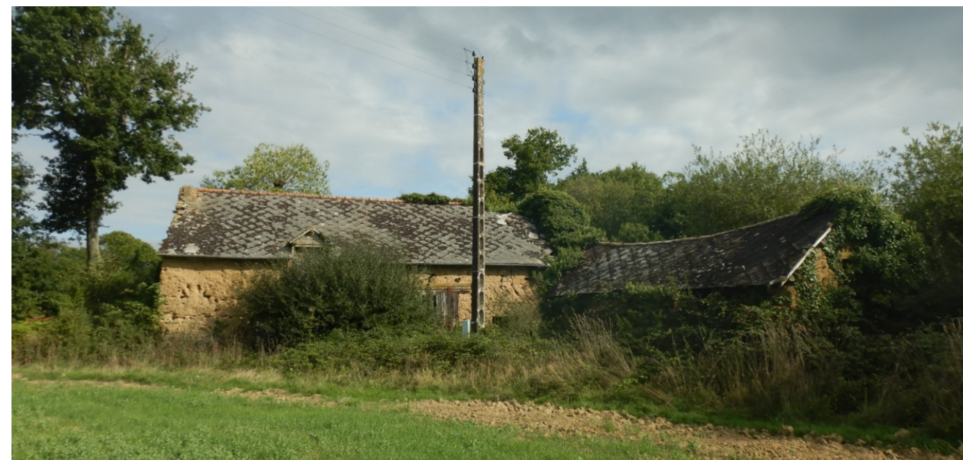
Photo 2 : bâtiments en ruine au lieu-dit Les Guerches
