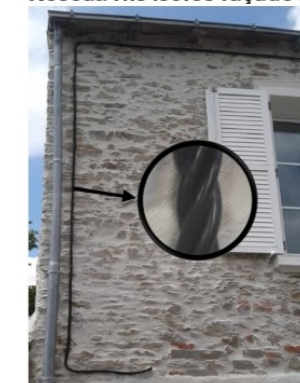
Réseau fils isolés façade BT
