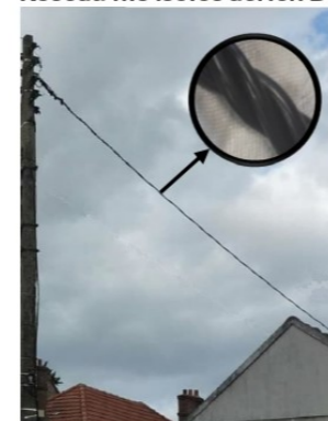
Réseau fils isolés aérien BT
