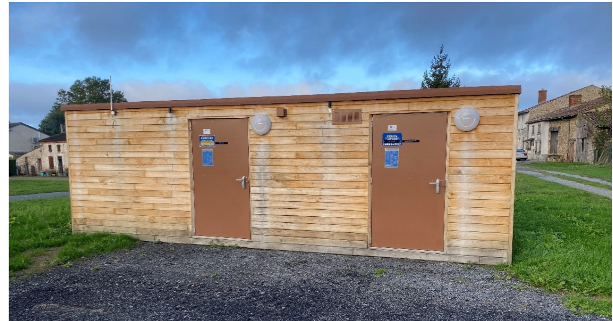
Photo 3 : exemple de poste de livraison électrique avec un bardage bois (Source : Vensolair)
