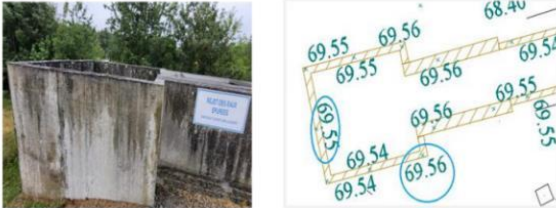
Figure 60 : Ouvrage de rejet vers la Scarpe
