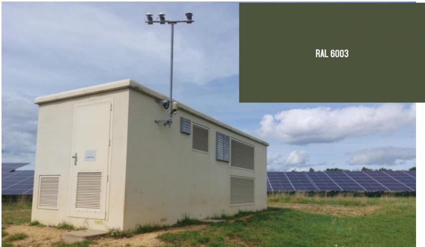
Figure 100 : Exemple de poste de livraison (TSE, 2025.)
