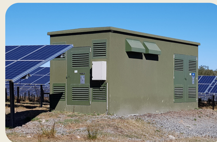
Exemple de poste
