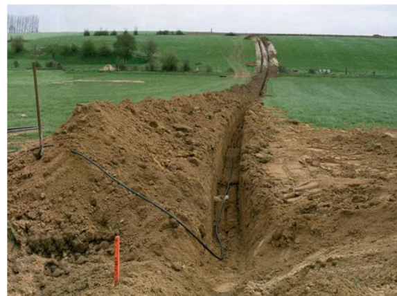
Photo 5 : Exemple de tranchée ouverte depuis 2 mois
