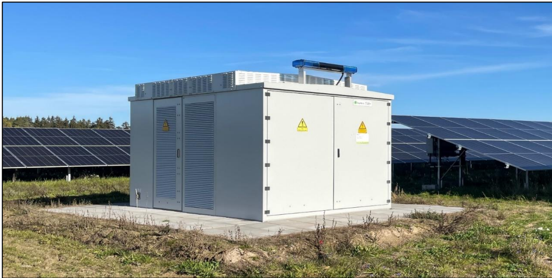
Figure 20 : Poste de transformation (Source : BayWa r.e.)
