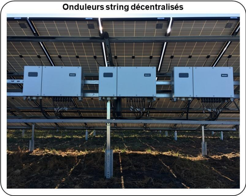
Figure 19 : Onduleurs string (Source : BayWa r.e.)
