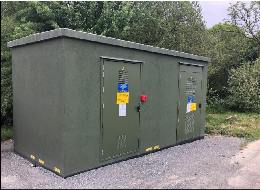
Figure 21 : Poste de livraison de teinte vert foncé (RAL 6003) (Source : BayWa r.e.)
