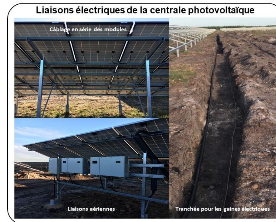
Figure 18 : Liaisons électriques (Source : BayWa r.e.)
