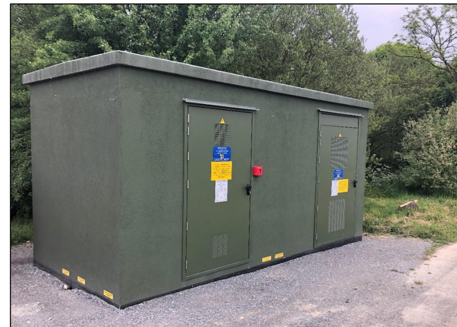
Figure 44 : Poste de livraison de teinte vert foncé (RAL 6003) (Source : BayWa r.e.)
