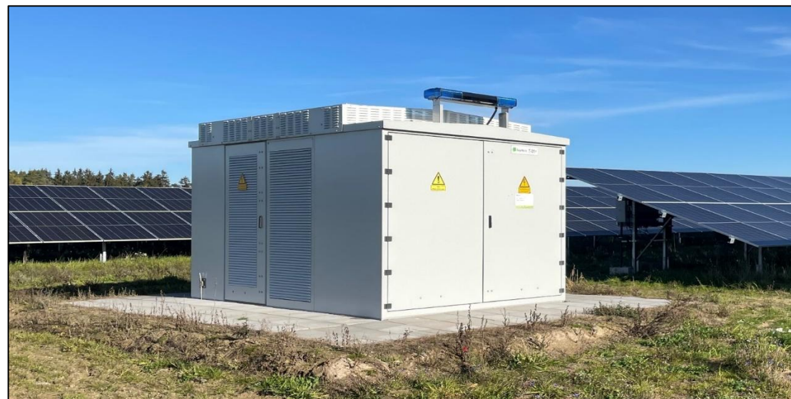
Figure 43 : Poste de transformation (Source : BayWa r.e.)
